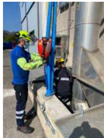
Plant di Palazzago - Procedure di sicurezza e utilizzo dei DPI
